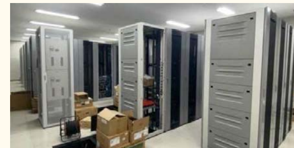
NW機器、サーバ搭載ラック
